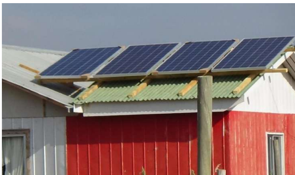
Figura 22: Paneles solares instalados en vivienda
