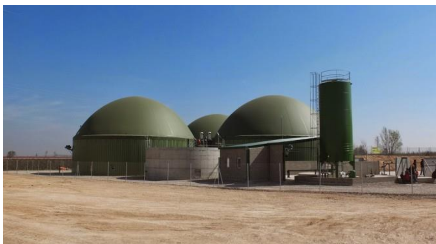
Figura 52: Planta de biogás
