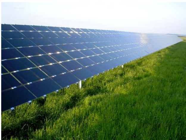
Figura 44: Panel solar fotovoltaico de tipo capa fina
