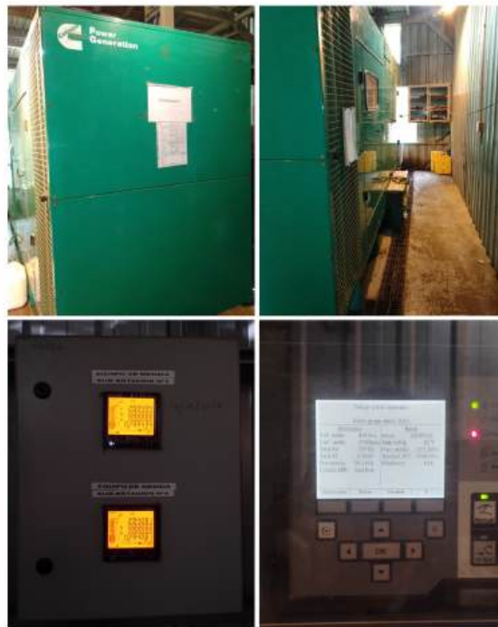
Figura 14. Grupos electrógenos y equipo de medida de subestaciones, planta eléctrica de Juan Fernández.
